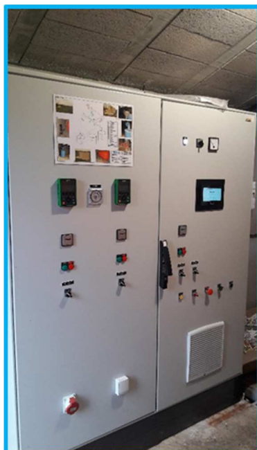
Castries – Station Candinières : Armoire électrique
