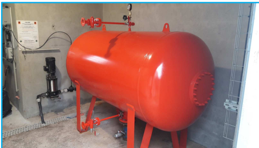
Castries – Station de pompage de Candinières : Dispositif anti-bélier
