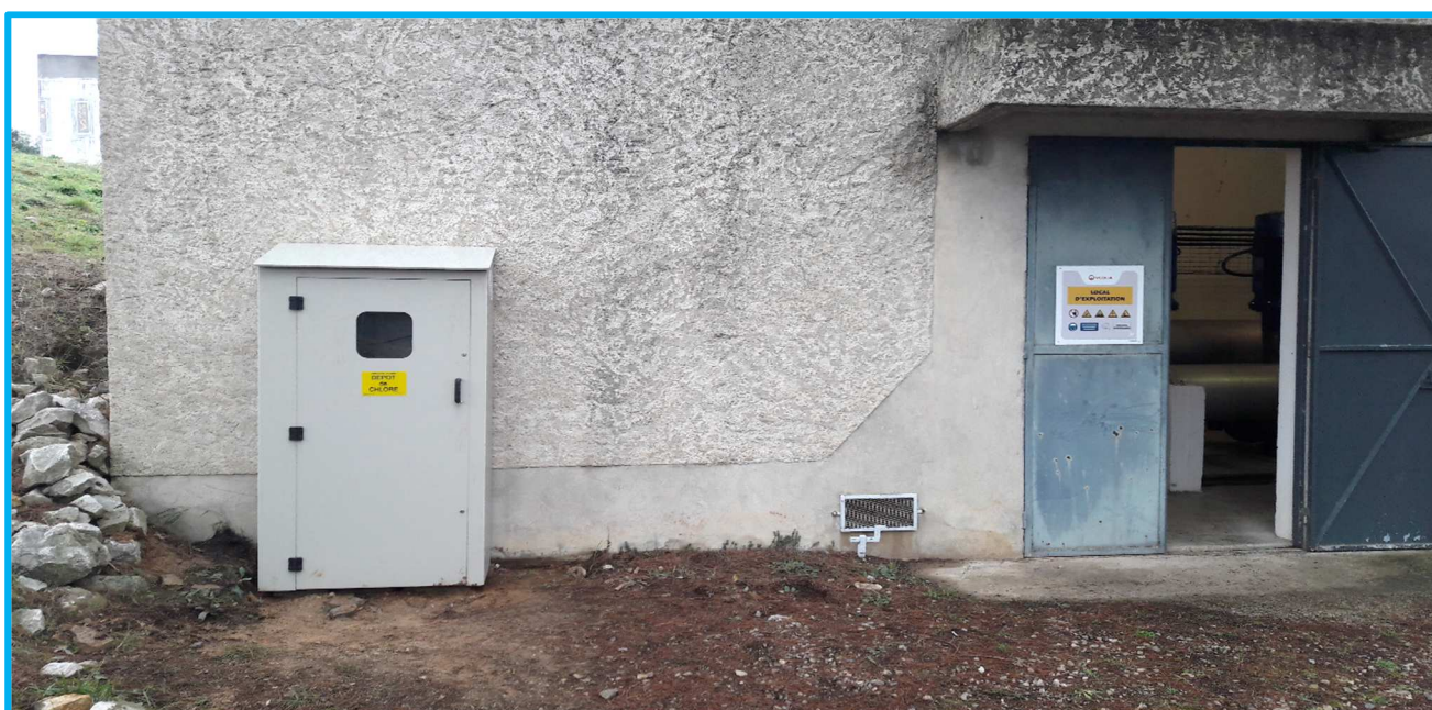
Castries – Station de reprise de Malrives : Armoire de stockage chlore gazeux
