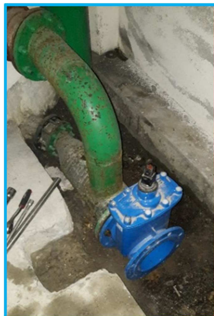
Baillarques – Réservoir : Vanne de vidange
